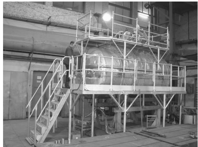
Рис. 9. Внешний вид экспериментальной установки с платформами для обслуживания.
